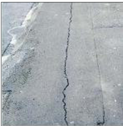
Figura 8: Esempio di fessura longitudinale
