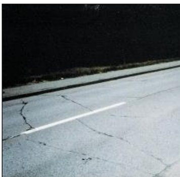
Figura 3: Esempio di fessurazione trasversale
