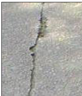
Figura 2: Esempio di fessurazione longitudinale
