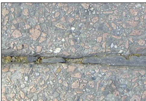
Figura 5: Degrado dei giunti precedentemente sigillati
