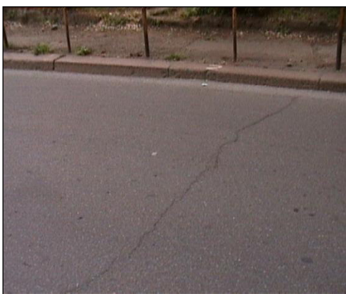
Figura 10: Esempio di fessura trasversale
