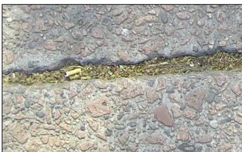
Figura 4: Degrado dei giunti non sigillati
