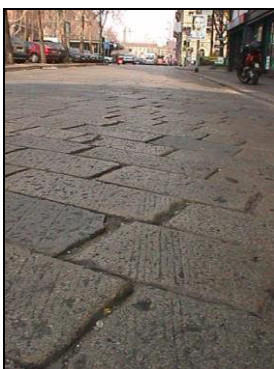
Figura 12: Eccessiva apertura dei giunti non sigillati
