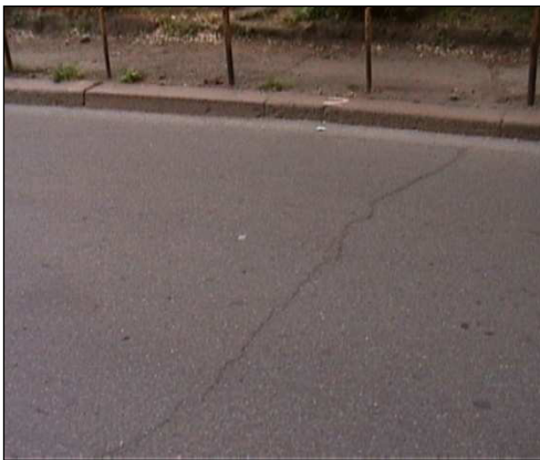
Figura 10: Esempio di fessura trasversale
