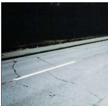
Figura 3: Esempio di fessurazione trasversale
