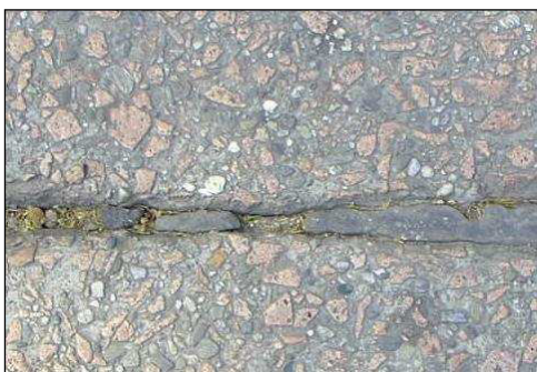
Figura 5: Degrado dei giunti precedentemente sigillati
