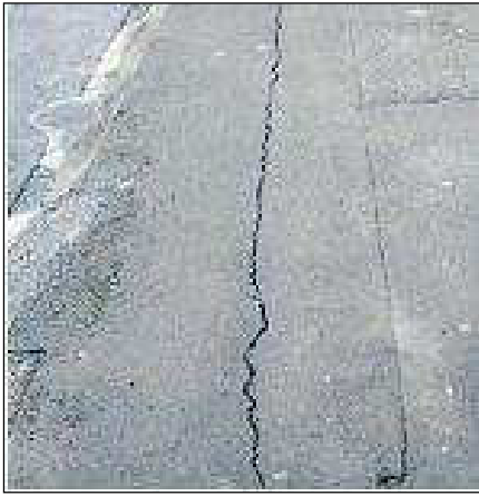
Figura 8: Esempio di fessura longitudinale
