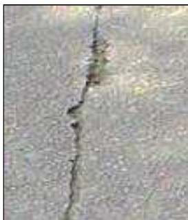
Figura 2: Esempio di fessurazione longitudinale
