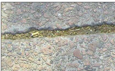
Figura 4: Degrado dei giunti non sigillati
