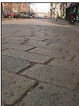
Figura 12: Eccessiva apertura dei giunti non sigillati
